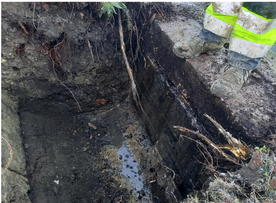
Figur 26: Kraftig rodvækst bag betonmur har beskadiget fuge under granitsten. Bagside af betonmur fremstår intakt. Foto: Artelia.
