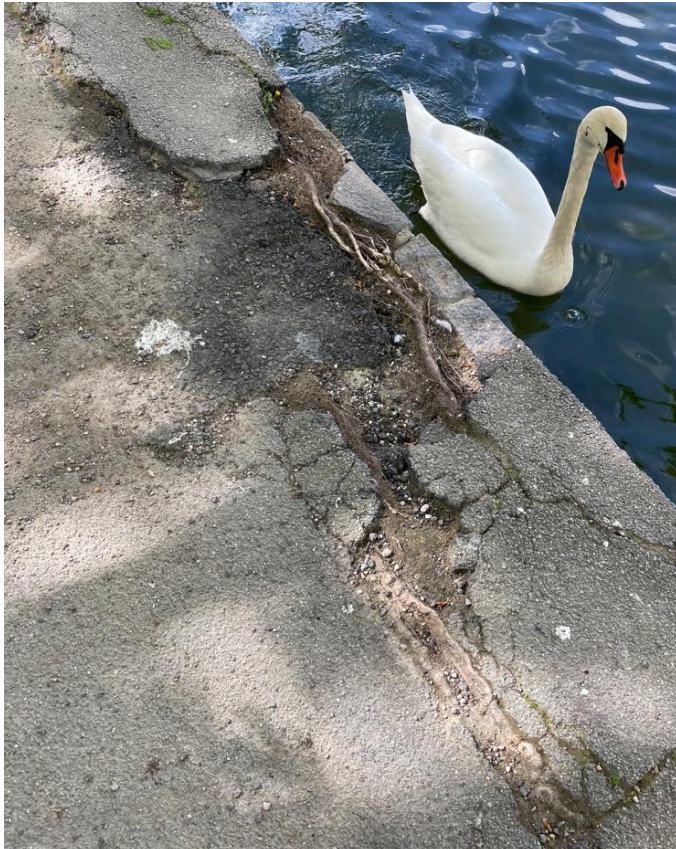
Figur 7: Trærødder som er brudt igennem asfaltbelægning helt ude ved søkant. Foto: Københavns Kommune
