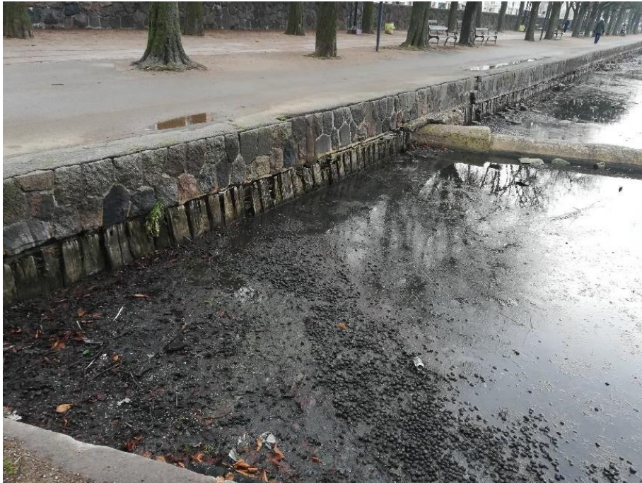
Figur 3: Søkant på del 1 i nordlig ende. Betonrøret der ses gå igennem træspunsen, er en rørledning der forbinder Sortedams Sø med søen i Fælledparken. Foto: Artelia.
