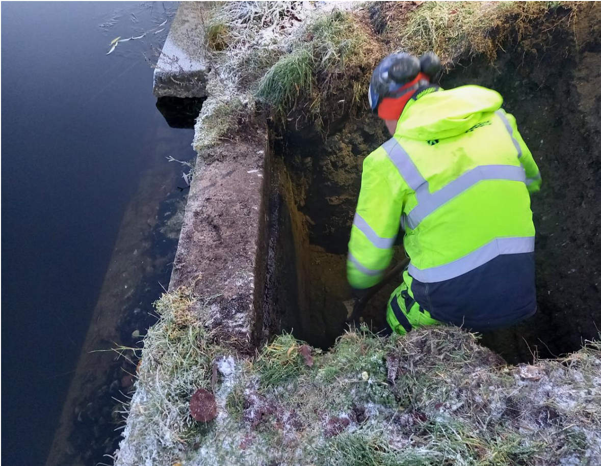
Figur 30: Granitsten er faldet i søen, bl.a. på grund af nedbrydning af forsiden af betonmur. Foto: Artelia.
