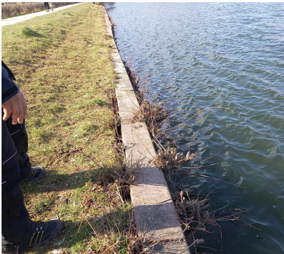
Figur 29: Løsnede granitsten, bl.a. grundet selvsået beplantning. Foto: Artelia.
