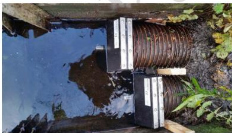
Figur 1-6 Udløbsrør fra Kagsmosen øst med højvandsklapper.
