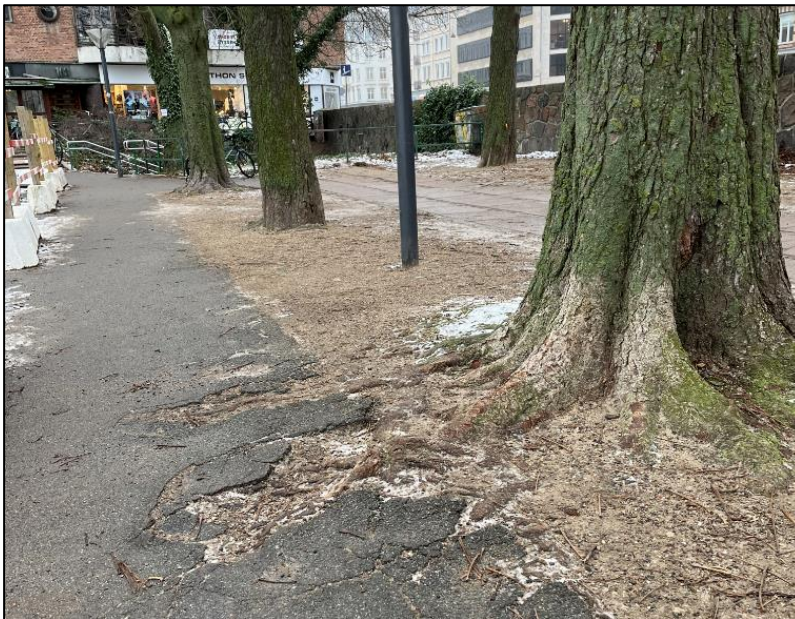
Figur 4. Terrænnære træerødder. Afspærring mod søen anes i venstre side.
